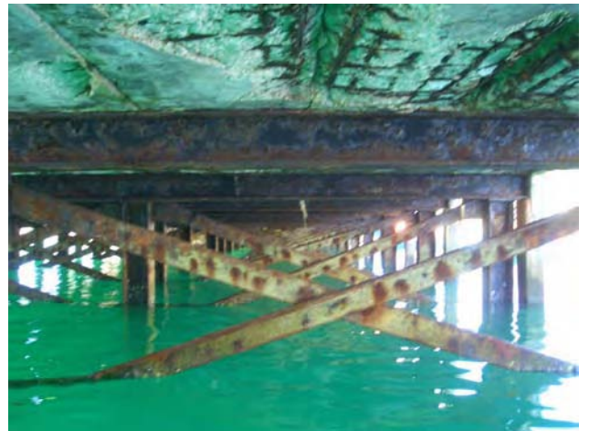
写真-3：既存栈橋の上部工は全面にわたりコンクリートが剥落し、鉄筋が爆裂して大型船舶の発着には危険な状態である。杭・梁のH型鋼は全体に錆が見られ、一部には穴があく等著しい腐食が見られる。
