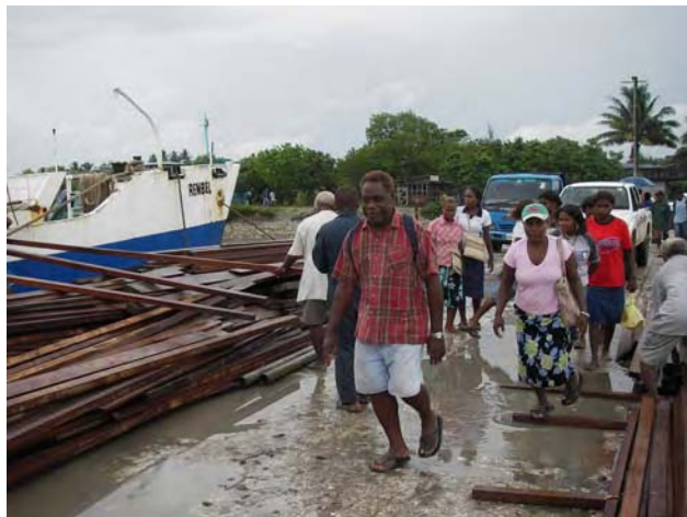
写真-2：既存栈橋では乗降客や建材などの積荷が錯綜している。床も損傷が激しく、雨の後は水たまりが多く見られる。
