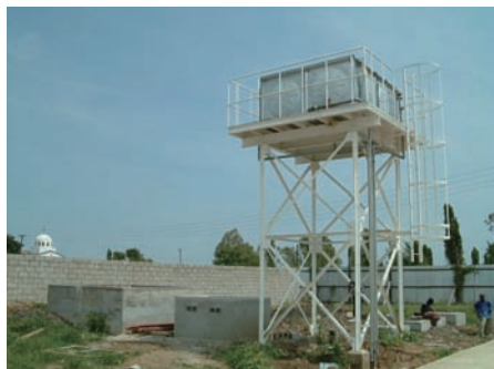
c. 高架水槽、受水槽と水道メーター
