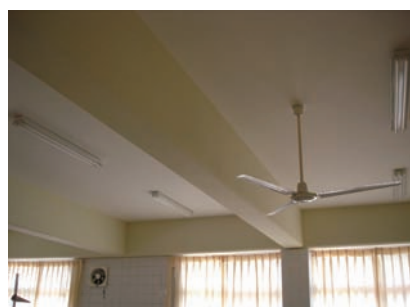
12. 実習室(1) 照明の配置
