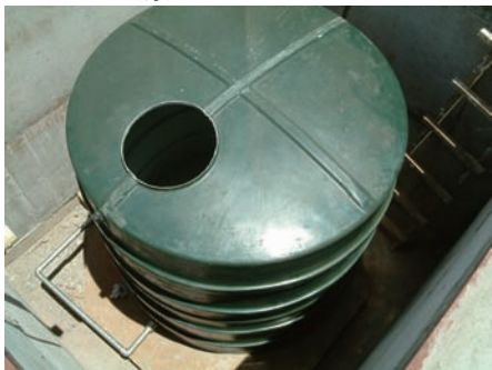
d. 受水槽内貯水タンク
