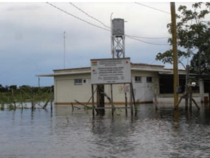
1. 外観(正面) 冠水の様子
