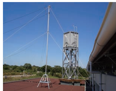
3. 屋上 高置水槽、アンテナ
