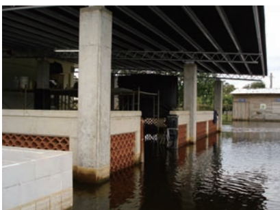
4. 待合ホール 冠水の様子
