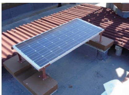
4. 屋上 無線用ソーラーパネル
