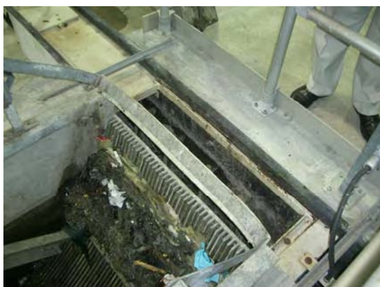
付写真 3-2-5 浮遊ゴミ回収装置
