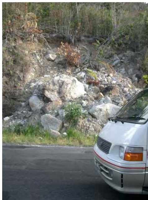
付写真 3-2-2 道路際の地すべり
