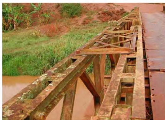
上部工の腐食
