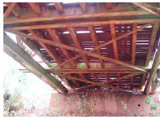
桁下面の腐食
