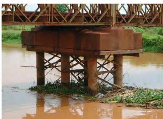
橋脚部鋼管とプレースの腐食
