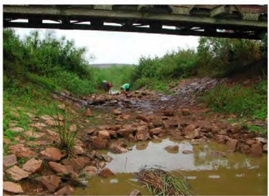
護岸工の先掘
