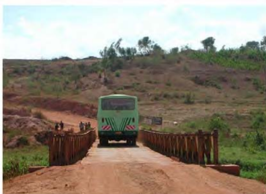
バスの通行による上部工のたわみ
