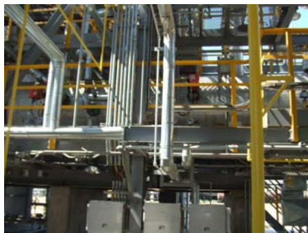
硫黄回収施設（アティラウ製油所）
