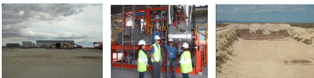
(新設熱処理設備建家)
