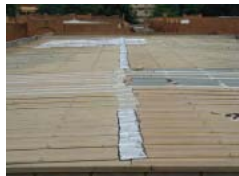
イサカガゾビ産婦人科病院 手術棟 屋根防水補修の跡
