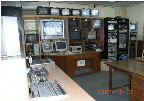
テレビマスターコントロール
