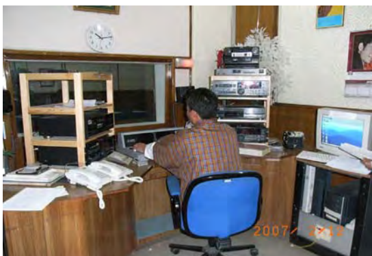
ラジオスタジオ副調整室 (約 17 m 2 )
