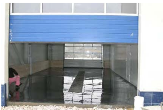
写真-5：同センターの機械洗浄室。水道は既に使用可能な状態になっている。排水設備も整備済み。
