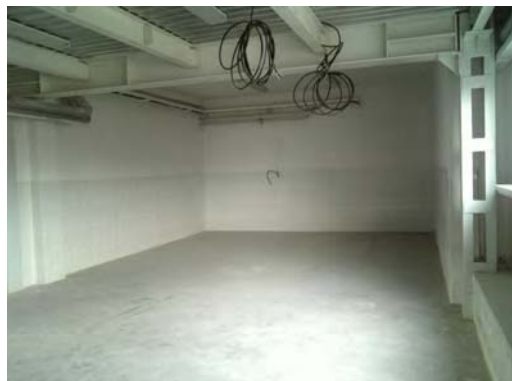
写真-4：同センターのワークショップ内、機械加工室。計画機材のための電力ケーブルも敷設済み。
