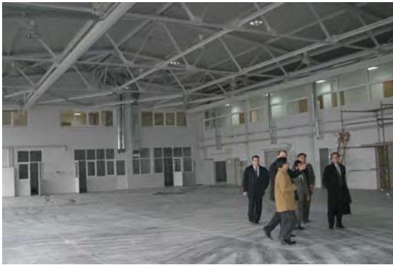
写真-3：同センターのワークショップ。計画機材の据付および使用に十分なスペースがある。床内には計画機材のための電力ケーブルも敷設済み。天井クレーン据付のためのレールも設置済み。
