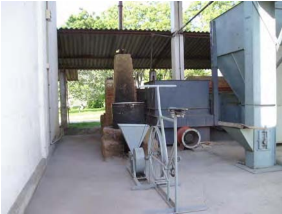
写真 7 パーボイル加工装置
