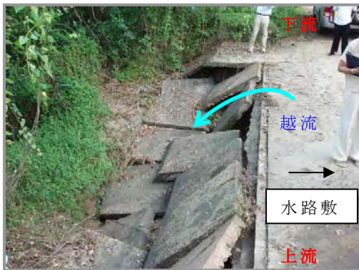
写真4 マラガウエア地区の用水路の余水吐
