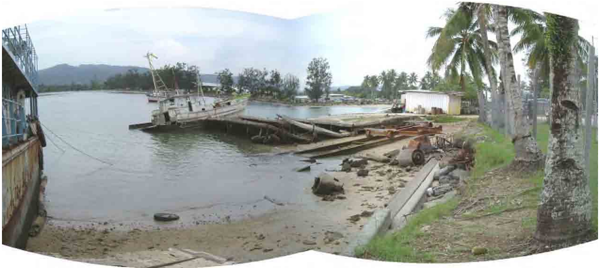
ウェワク既存棧橋（中央部が破損した棧橋、中央および左側に座礁船、右側は上架用クレードルとレール）
