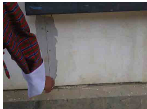
外壁ボード目地の剥がれ
