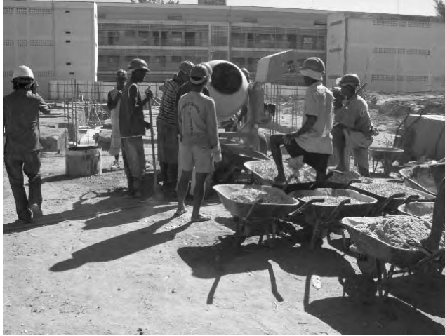
コンクリートミキサー（0.25m 3 ）周囲の状況、4台のミキサーは終日フル回転で使用されている。
