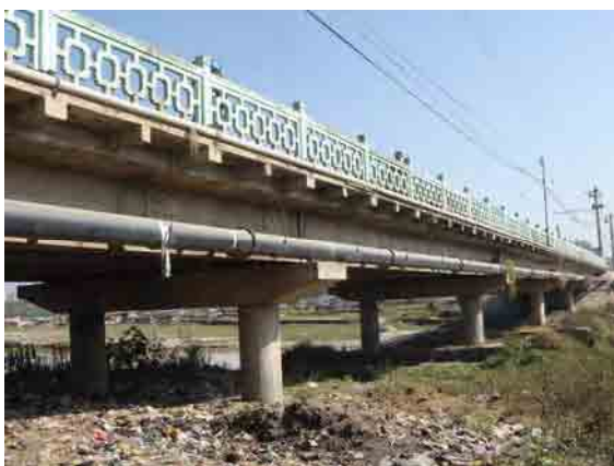
既存マノハラ橋 水道管、電気ケーブル、通信ケーブルが添架されている
