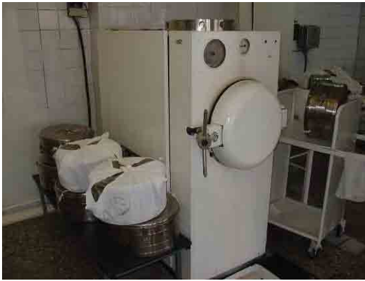
写真-7：別館 2F 中央材料滅菌室の故障した旧ソ連製高圧蒸気滅菌器（1988 年製）。内蔵ボイラーのヒーターが断線し、蒸気が作れず使用できない。
