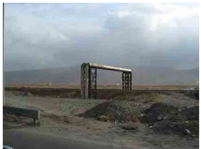
温水供給パイプライン (鉄道を跨ぐ露出配管箇所)
