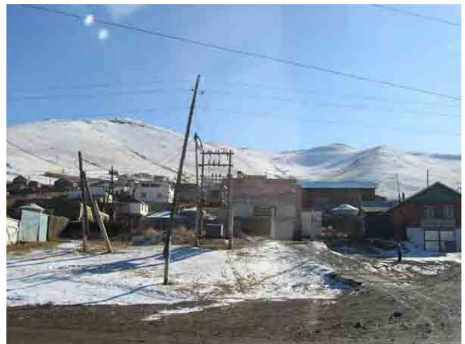
ゲル地区にある電気設備 (トランスの設置状況)
