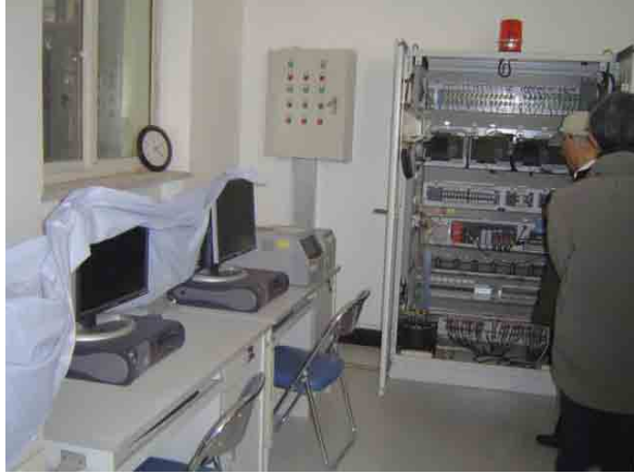
燃焼炉コントロールルーム
