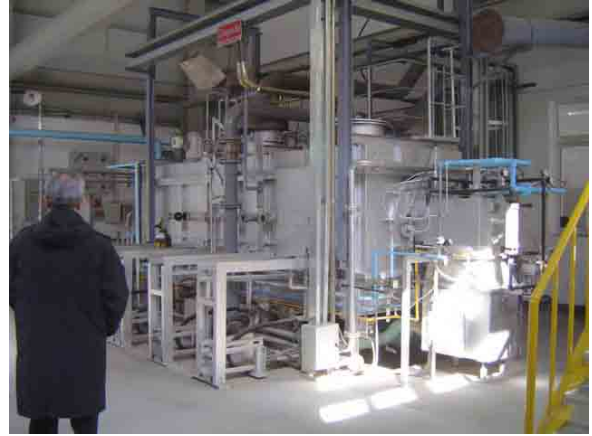
多機能燃焼実験炉設備全容
