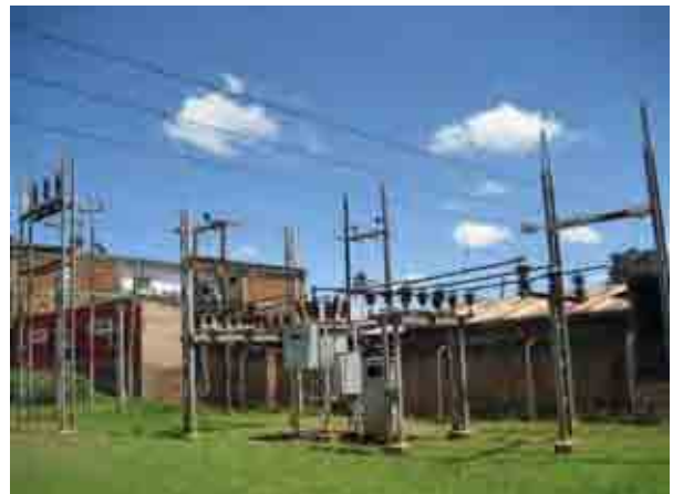
既設イガンガ変電所の様子(33kV 開閉設備)
