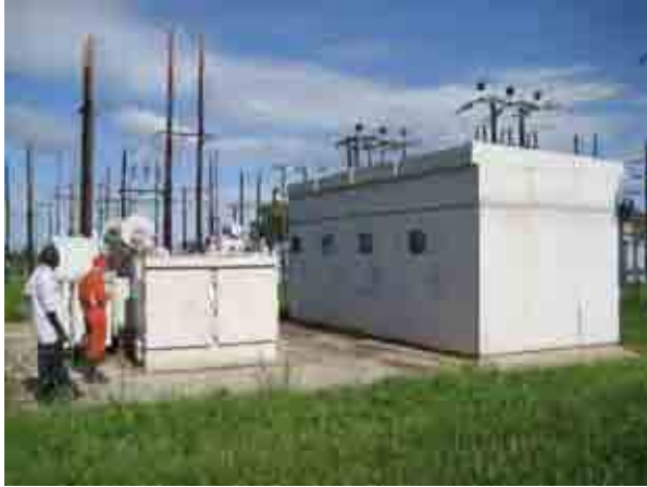
ホイマ変電所
