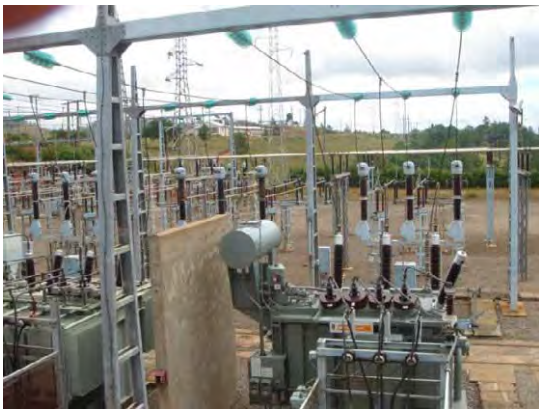
(Ambohimambola Dispatch Control Center: 屋外開閉設備)
