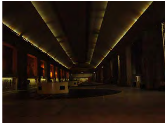
(カボラバッサ水力発電所:発電機室)
