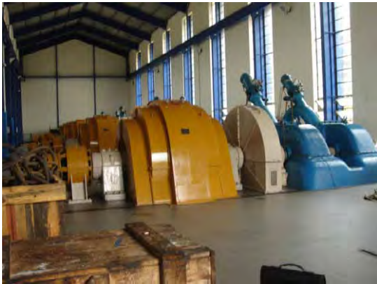
(Mandraka 水力発電所:ペルトン水車発電機 6MW×4=24MW)
