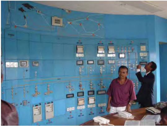
(Ambohimambola Dispatch Control Center: 系統監視制御盤)
