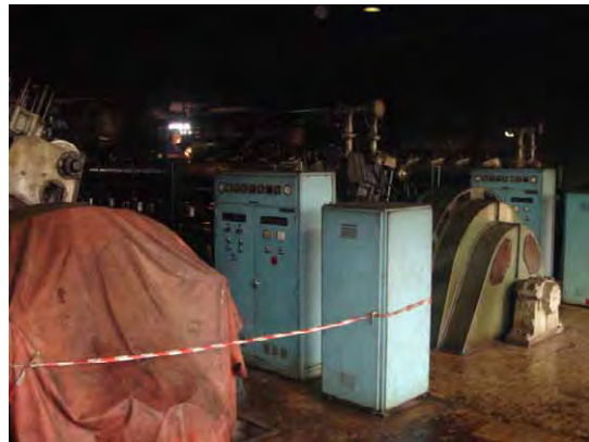
(Ambohimanambola ディーゼル火力発電所: 6 MW×3台)
