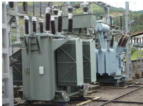
(Mandraka 水力発電所:3.2/63kV 7.5MVA 昇圧変圧器)
