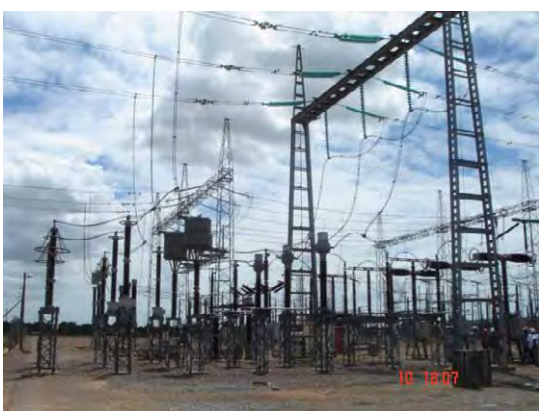
(Infulune 変電所:275kV×2 回線受電側設備)
