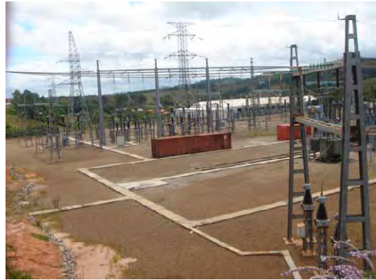
(Ambohimambola Dispatch Control Center: 屋外開閉設備)
