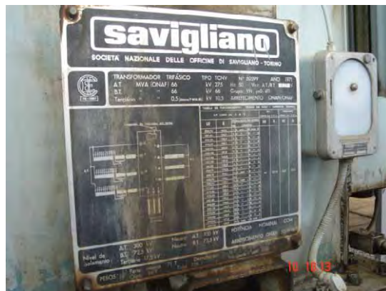
(Infulune 変電所:275/66kV 66MVA 主要変圧器銘板)
