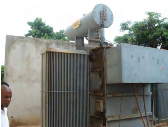
(TeTe 変電所:33/6.6kV 変圧器)
