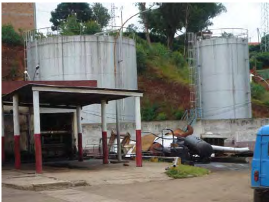
(Ambohimanambola ディーゼル火力発電所: 燃料タンク)
