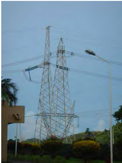
(カボラバッサ水力発電所:533kV 直流送電線及び 330kV 交流送電線)
