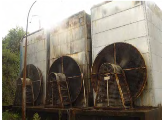
(Ambohimanambola ディーゼル火力発電所: ラジエータ)
