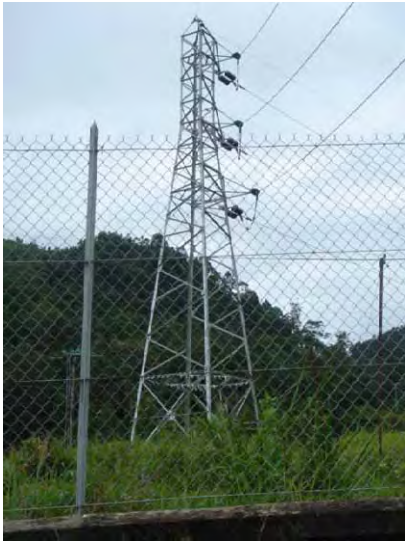
(Mandraka 水力発電所:アンタナナリボ向け 63kV 送電線 1 回線)
