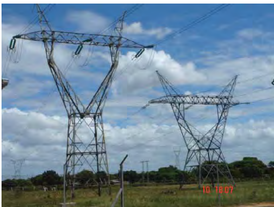
(Infulune 変電所:275kV×2 回線送電線)
