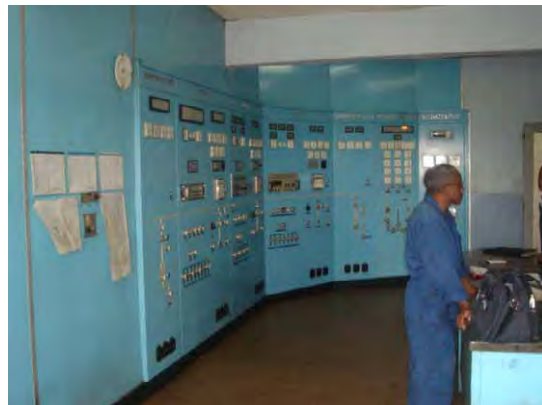
(Ambohimanambola ディーゼル火力発電所: 監視制御盤)
