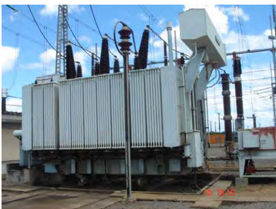
(Infulune 変電所:275/66kV 66MVA 主要変圧器 イタリア製)
