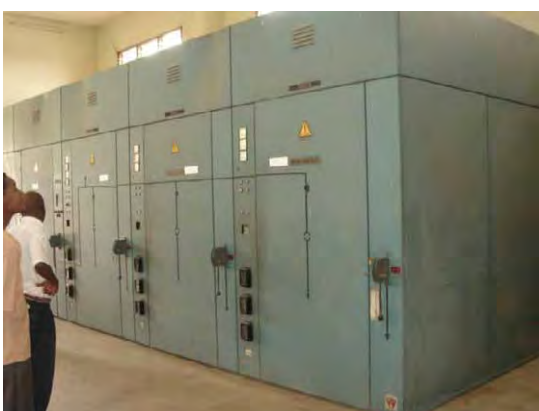
(TeTe 変電所:33kV スイッチギアー)
