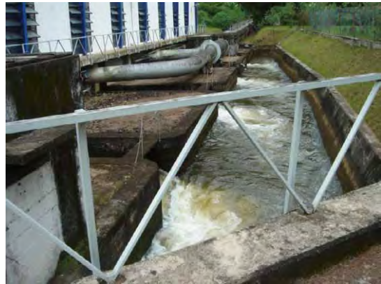
(Mandraka 水力発電所:水圧鉄管と放水路)
