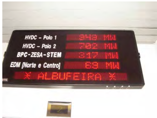
(カボラバッサ水力発電所:当日の発電電力量)
