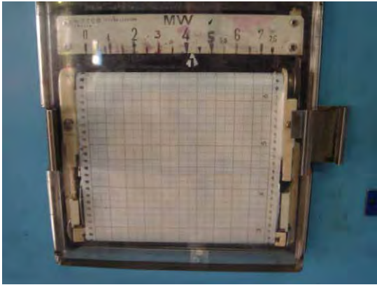
(Ambohimanambola ディーゼル火力発電所: 3台の内1台は当日出力4.2MWを計測)
