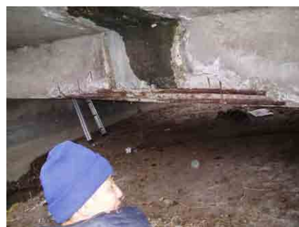
Обнажение и коррозия арматуры (балки)
