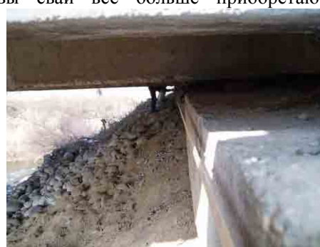
Деформация берегового устоя
