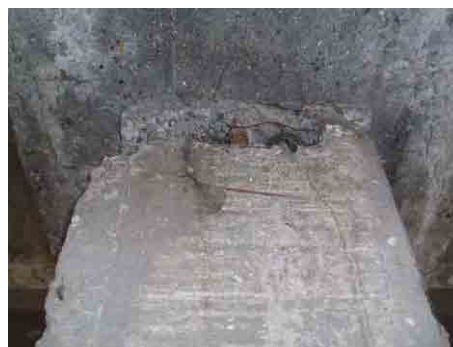
Повреждение верхнего конца опорного быка
