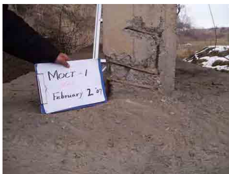
Повреждения нижнего конца опорного быка
