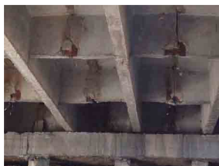
Разрывы между поперечными балками
