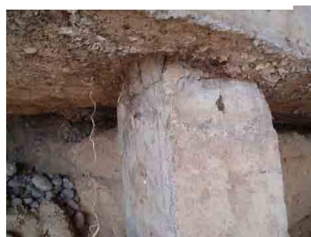
Повреждения бетонных элементов в нижней части
