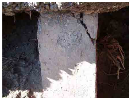
Повреждение головы сваи
