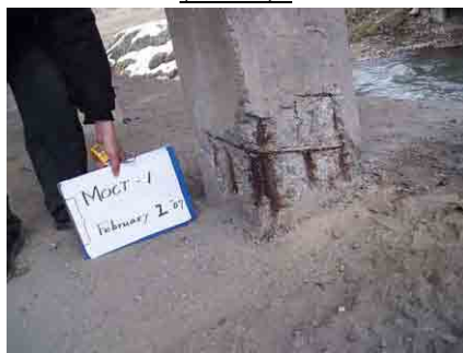
Обнажение и коррозия арматуры (опоры)
