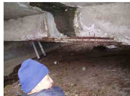
鉄筋の露出・腐食 (桁)
