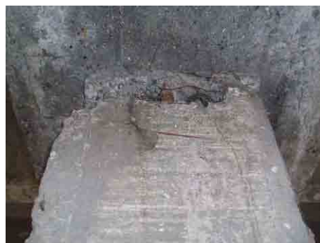
橋脚上端の損傷
