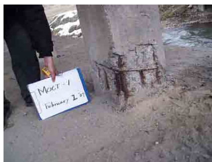
鉄筋の露出・腐食（橋脚）
