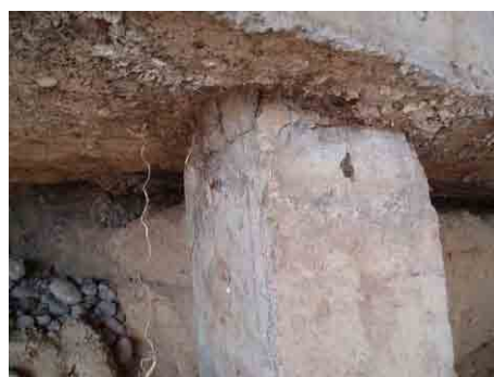
下端部のコンクリート部材の損傷
