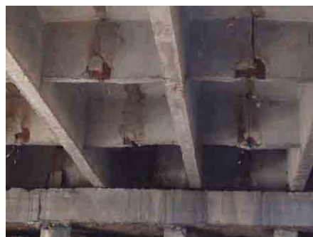
横桁の不連続
