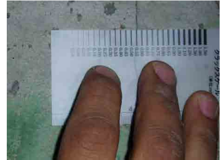
クラックスケールによる検査
