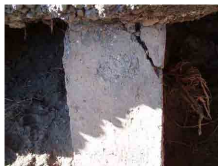
杭頭部の損傷
