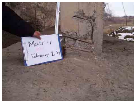
橋脚下端の損傷
