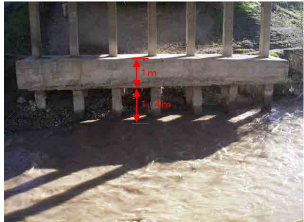
橋脚(右岸) 基礎杭が洗掘により露出
