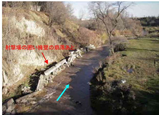
河川状況(橋梁より下流を望む) 左岸は崖地となっている
