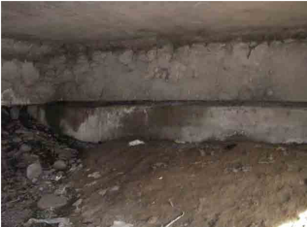
橋台(下り線橋梁) 10~30cm沈下している
