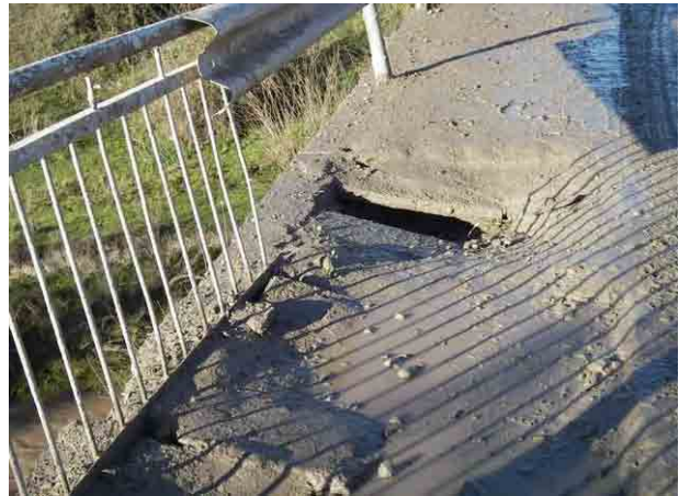
歩道部 PC板の落下により歩道に穴が開いている
