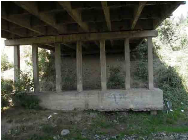
橋脚(左岸) 下流側基礎杭が洗掘により露出
