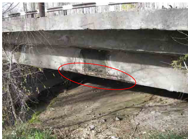
桁の鉄筋腐食(下り線橋梁) コンクリート厚が不十分な箇所排水孔からの水で腐食した
