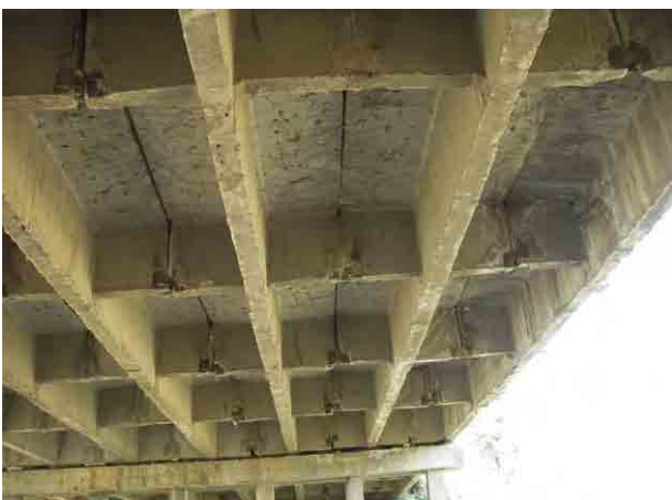
T型 プレキャストRC桁 (スパン14m) このタイプは桁相互を一体化できないため交通 により損傷し易く、日本では使われていない
