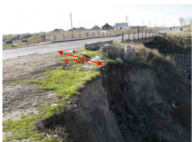
下流右岸状況 路肩まで崩落が迫っている
