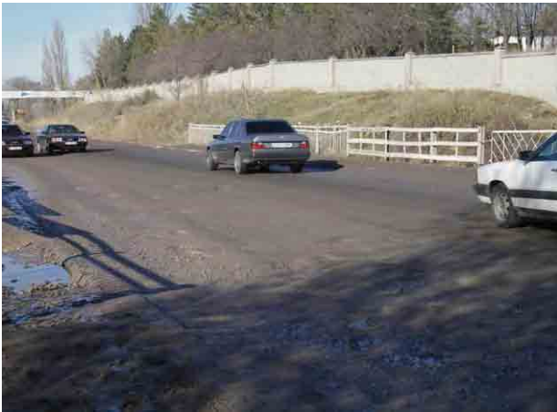
橋面状況 ポットホールが多数有り
