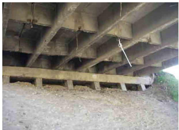
橋台(右岸) 盛土の圧縮沈下により杭が露出している
