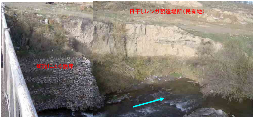
下流左岸状況 崖が洗掘を受けている(崖部が水衝部となっている)
