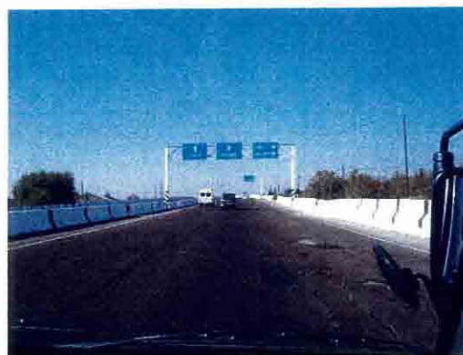
Tashkent-Jizzax (縦断方向にひび割れ)
