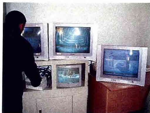
トンネル監視モニター
