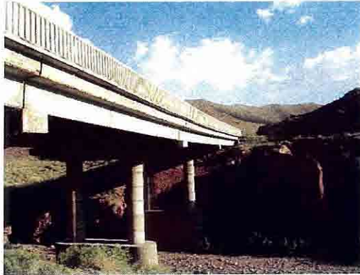
RC18m×3 span=54m (主桁にたわみが見られる)
