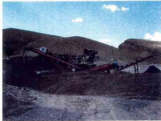
クラッシャープラント
