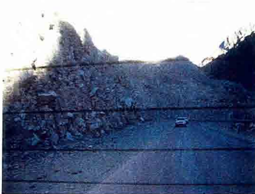
急勾配切り土 (多くの浮き石が見られる)
