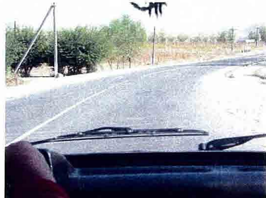
イランコントラクターによる施工区間 (平坦性が悪い)
