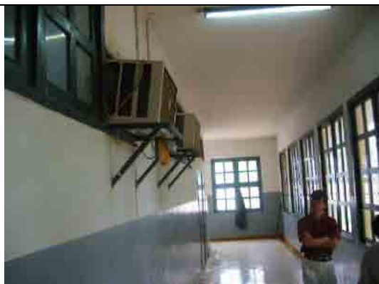
手術室廊下側にはみ出したウインドクーラー
