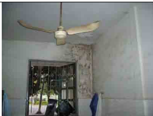
スタッフ更衣室(外壁に面する壁は雨水が漏水)
