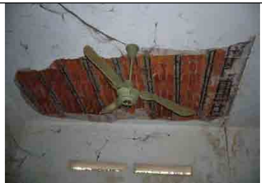
スラブが剥離・落下し、鉄筋が露出して危険
