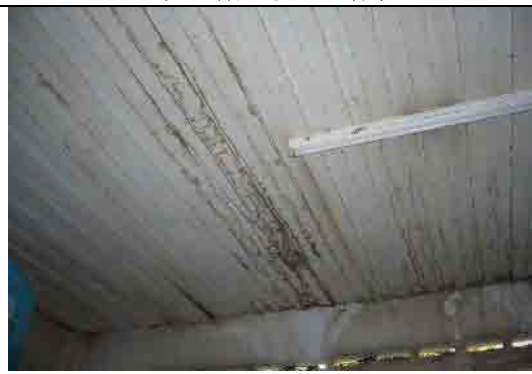
雨漏りをしている木製天井
