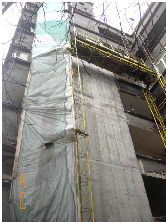
④ブカレスト市内の補強建築物
