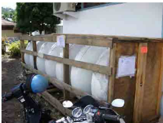
納入されたサイレン
