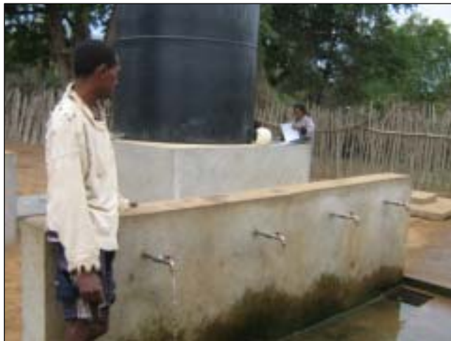
Un robinet défaillant et la mousse avec la flaque d'eau
