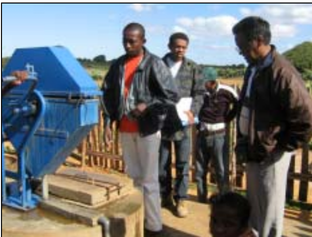
Constat du bon état actuel de la pompe
