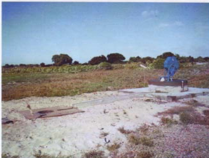
PUITS REHABILITE DE SIHANAMARO EQUIPE D'UNE POMPE ROPE
