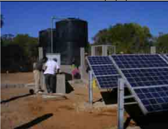
Projet pilote 1 système solaire à Bemamba F006
