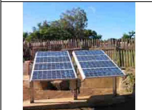
Système solaire dans la ville d'Ambovombe
