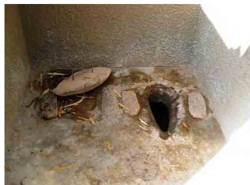
写真-16 DANIDA による小学校トイレの内部構造 ガングルグ県 Méguet 郡 Vinnogo 村小学校のトイレ。2槽式の便槽で、1槽は蓋を閉め交互に使用する。
