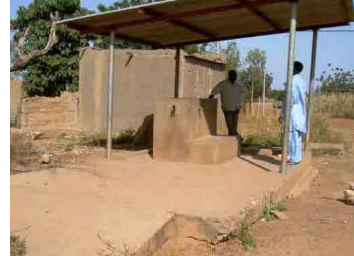
写真-8 Mogtédo 村の公共水栓 Mogtédo 村の簡易給水施設の公共水栓、3 つ蛇口があり、10 基の共同水栓が設置されている、訪問時は燃料切れで給水されていなかった。水料金は 10Fcfa/20ℓ。
