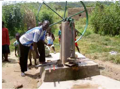
写真-12 Tiébélé 村の修理中 Volanta ハンドポンプ ナウリ県 Tiébélé 郡 Tiébélé 村のハンドポンプ修理人が、「ブ」国製の Volanta ハンドポンプを修理しているところ。修理人はハンドポンプの修理で生活している。
