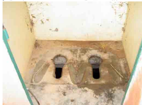
写真-14 左記トイレの内部構造 日本の無償の小学校建設計画によるトイレの内部構造、2槽式となっており片方の便器はコンクリートの蓋をしなければならぬが、校長・教員が替わり引き継がれていない。
