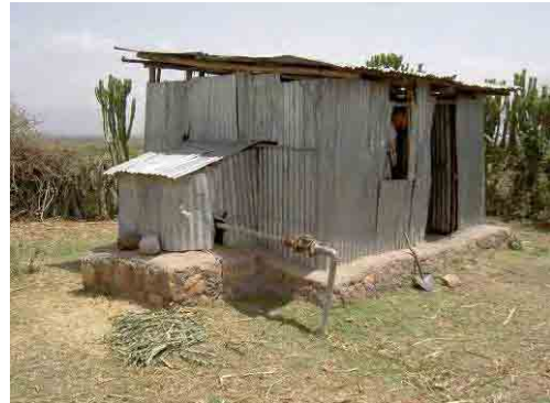
写真-6 Hadelga 村の既存深井戸とポンプ小屋 1997 年に旱魃対策として設置された。帯水層は沖積層。 口径 5 インチ、深度 144m、静水位約 40m、揚水量 10l/s。 発電機を電源とした水中ポンプによる揚水。
