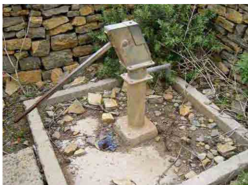
写真-19 Enderta 郡 Maiumer 村の放棄されたハンドポンプ
