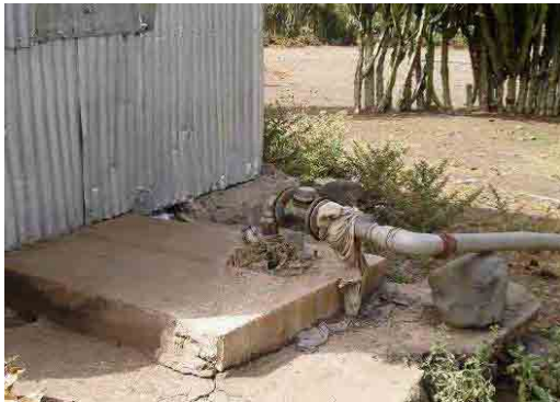
写真-11 Raya Azebo 郡 Adi Kiros 村の深井戸 沖積層中の深井戸。深度100m、ポンプの揚水量30/s。発電機を電源とした水中ポンプによる揚水。
