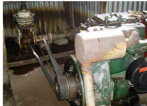
写真-14 Genete 村の深井戸・動力ポンプ 1996年に水資源局が建設した82m深井戸。井戸のリハビリの他に、故障が多くなったディーゼルエンジン駆動のMONOポンプを発電機・水中ポンプへの交換を希望。
