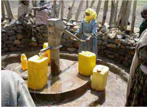
写真-25 Endamariam 村の Afridev ハンドポンプ Degua Temben 郡 Endamariam 村 (370 人)。REST による ハンドポンプ設置手掘り浅井戸。深度 17m。水料金 4 プル /年・家族。人口急増中のため追加のハンドポンプを希望。
