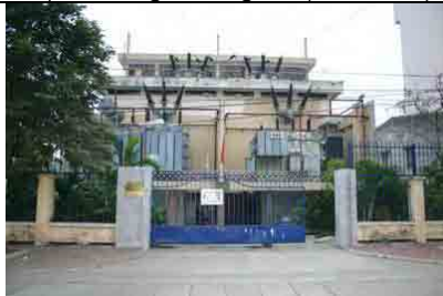
22) Trạm biến áp (Phúc Tân)
