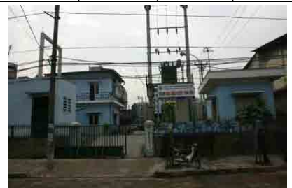
27) Trạm cấp nước (Phúc Tân)
