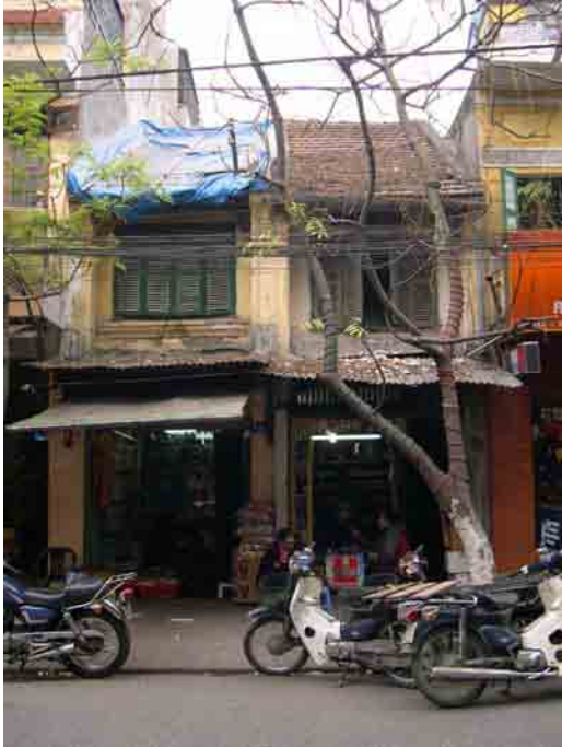
Nhà truyền thống xuống cấp (10 và 12 HB)
