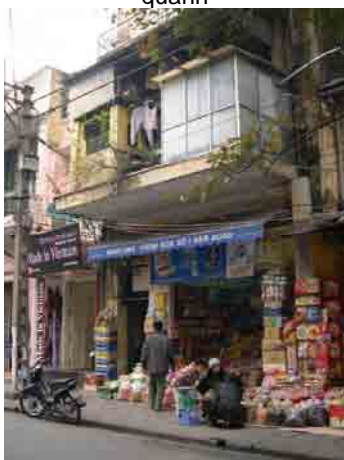
58 Hàng Buồm Ban công trở thành nhà vệ sinh, sử dụng vật liệu không phù hợp
