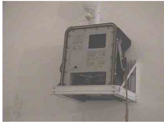
30 クリニカルセンター集中治療室の使用不能となった患者監視装置
