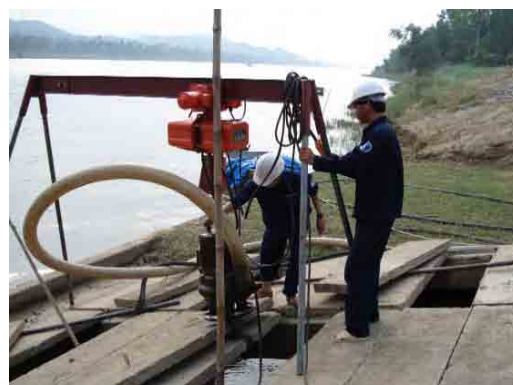
送水ポンプの維持管理
