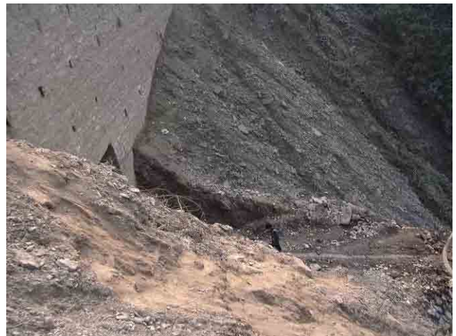
ナラヤンガートから28km地点。道路下部、ボックスカルバート内部が土砂により排水できない状況となっており、道路局により排土作業が行われている。
