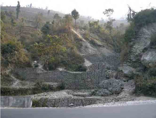
ナラヤンガートから 27.16km 地点。手前のチェックダムの右側が破壊されている。これは道路局により建設されている。奥のダムは治水砂防局により建設。
