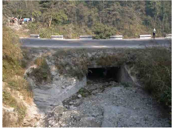
ナラヤングートから 18.46km 地点。他の排水路もこのようなボックスカルバートが多く、そのほとんどは毎年のように土砂により埋め尽されている。
