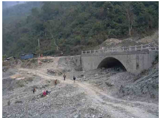
ナラヤングートから 21.56km 地点の谷側状況。アーチ状橋梁下部は土石流堆積物により埋められている。
