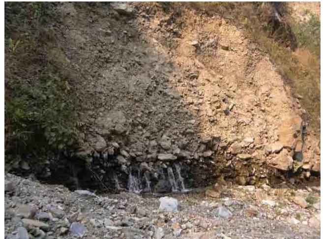
ルワ・コーラ出合から約600m上流部、左岸の状況。乾燥期にもかかわらずかなりの湧水があり、その上部斜面の状況から崩壊が懸念される。
