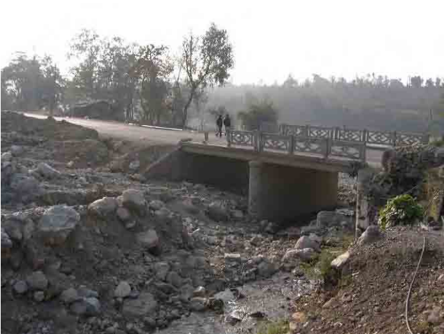
ダス・コーラの河床と橋梁の状況。河床高はすでに道路面を超えており、また橋梁のスパンは河床幅の半分程度しかない。
