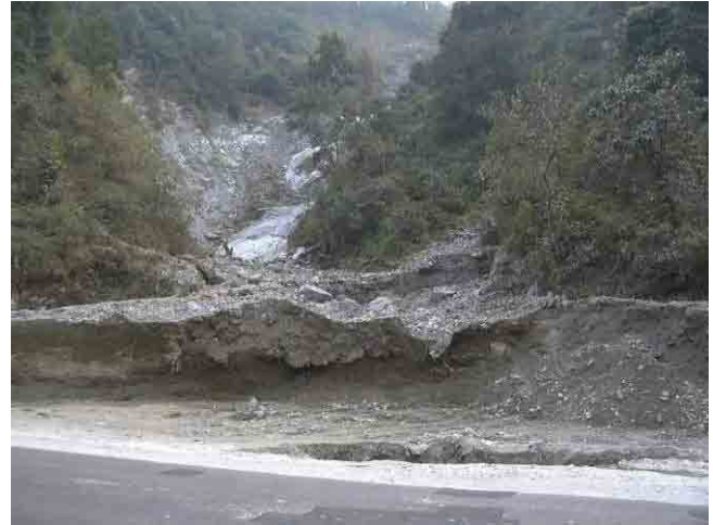
ナラヤンガートから 25km 地点。厚さ 4~5m 程の土石流堆積物が溪流部に残存している。この奥に見えるチェックダムは道路局により建設されている。
