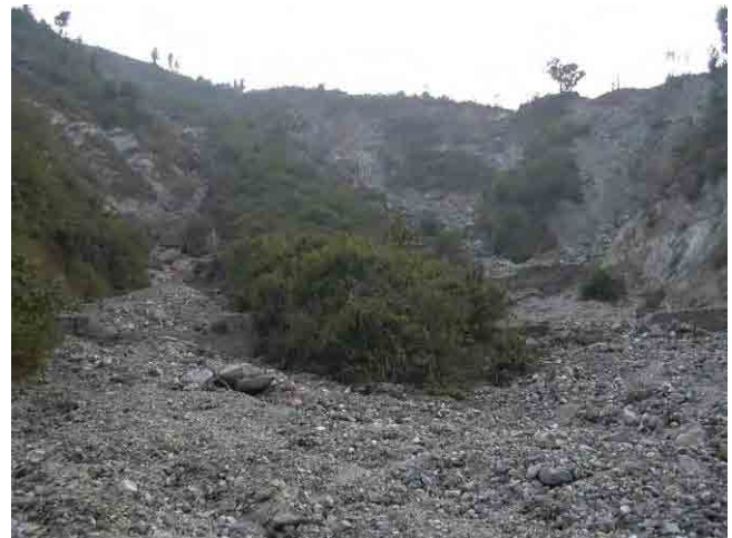
ナラヤンガートから 24.7km 地点の上流部斜面崩壊状況で、溪流内部のほとんどが崩壊斜面となっている。チェックダムも埋め尽された状態になっている。
