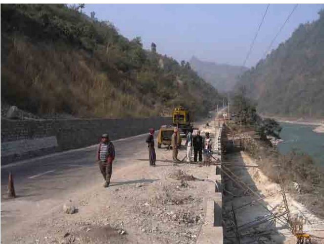
ナラヤンガートから 24km 地点。斜面崩壊土砂による路肩部が崩壊され、擁壁工事及びロックボルト工事が道路局により行われている。
