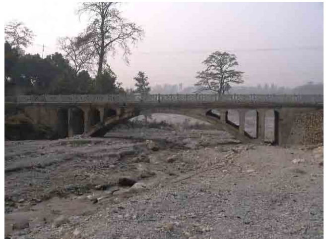
カハレ・コーラに架かる橋梁。2003 年の土石流災害で橋梁右側半分崩壊の被害を受けている。また、河床も上昇している。
