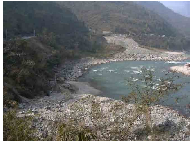
ナラヤングートから 21.7km 地点の谷側状況。トリスリ川のモンスーン期洪水により、道路斜面下部が洗掘され、治水砂防局により護岸工事が行われている。
