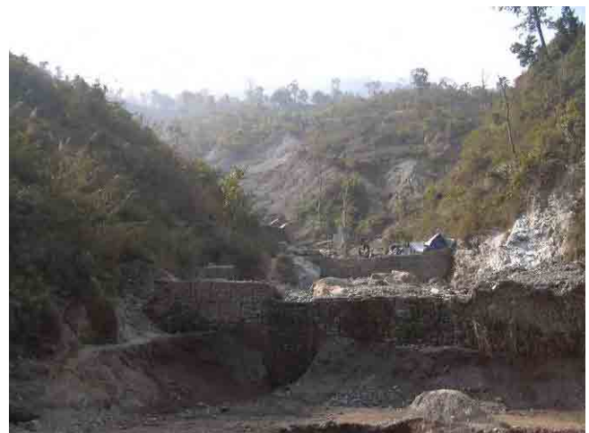
ナラヤンガートから 23.76km 地点。溪流内部の崩壊斜面が目立ち、土石流で満砂状況となっている。道路脇の土石流堆積物が道路局により排土されている。
