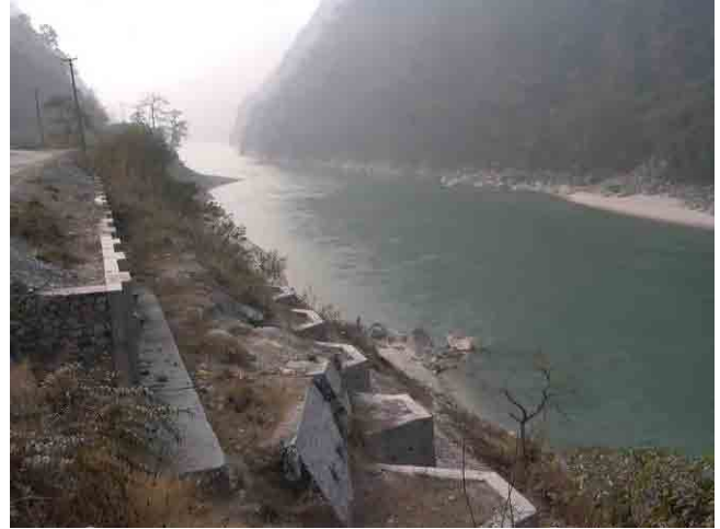
ナラヤンガートから 17km 地点。地すべりと河岸洗掘による路肩部補強工事が行われた。コンクリート擁壁とロックボルトにより対策している。
