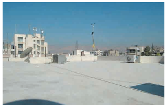
支局屋上に設置された気象観測機器
