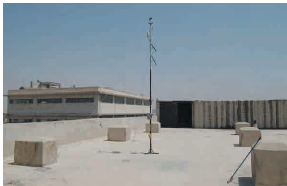
工場屋上の気象観測機器
