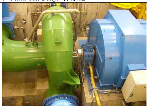
8 Santa Ana 配水場(発電機)
