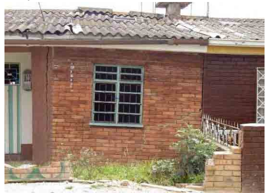
写真-38 地盤沈下による家屋の亀裂 地盤沈下による被害を受けているマドリッド市の民家。壁に大きな亀裂が入っており、塀は倒壊している。
