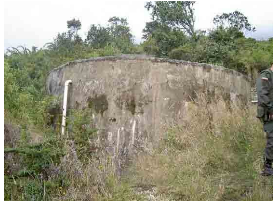
写真-14 ビラロジタの配水タンク (約 3200m) 自治会により谷川の水を引いて配水タンクに貯水して いる。各戸給水。毎月 2000 ペリ/世帯徴収している。
