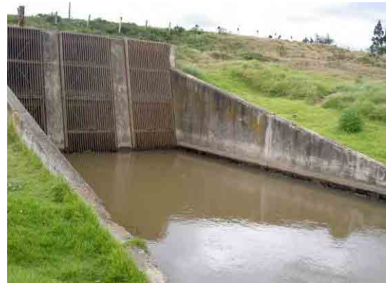
写真-32 テビトック浄水場の取水口 ボゴタ川から取水している。この付近ではシルトで濁っているが黒色の濁りや異臭は無く水質良い。
