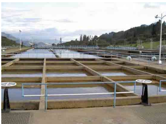
写真-31 テビトック浄水場 最大浄水能力は 10.5m 3 /s。水利用コンセッション 4.8 m 3 /s。運営はフランスの VIVENDI 社に委託している。
