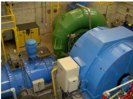
写真-29 サンタナ水力発電所 ウエスト-浄水場からの落差を利用した ACUSDUCTO のサナ水力発電所。水源はチンガサ水系。発電容量 12MW。
