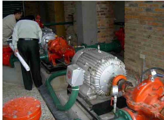
写真-4 北東部のポンプ場 コイトIIタンク(2675m)にある送水ポンプ。144m 3 /hが2台。
