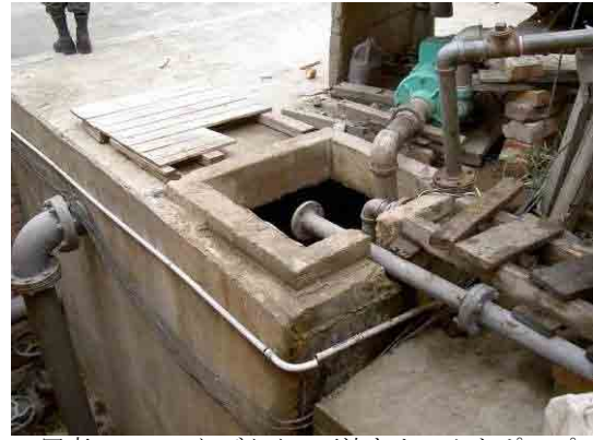
写真-26 アルトスデカスカの不法なタンクとポンプ Acueducto のパイプが水源で、このような大規模な配水タンクと送水ポンプが自治会？により不法に設置されている。
