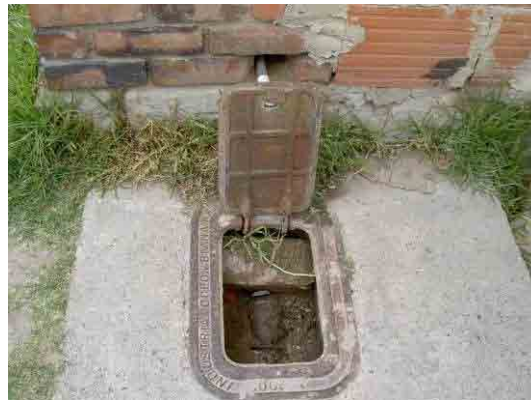
写真-18 シダートボリバル地区の水道メーター 同地区は水道メーターはほとんどの家にあるが、不法接続がかなり多い地域である。
