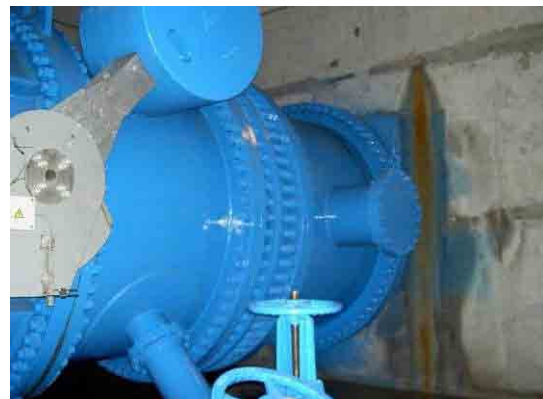
写真-30 導水トンネル出口のバルブ ウエスト-浄水場からボゴタ東部山地を通過しサナ水力発電所の手前に入る直径 3.5m のサナガバラ導水トンネル出口。バルブは無線で自動制御されている。
