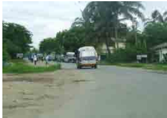
世界銀行により改修された 2 車線の Old Bagamoyo 道路。舗装の損傷が目立つ。
