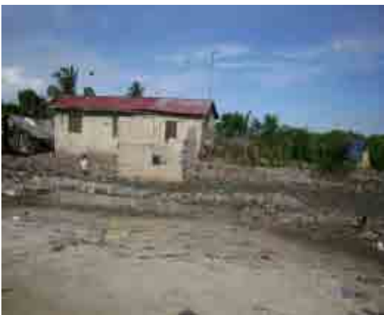
ムシンバジ川河川敷の住居。浸水した跡が残る。
