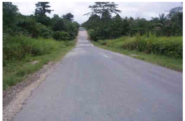
西ニューブリテン州ニュー・ブリテン・ハイウェイの舗装損傷
