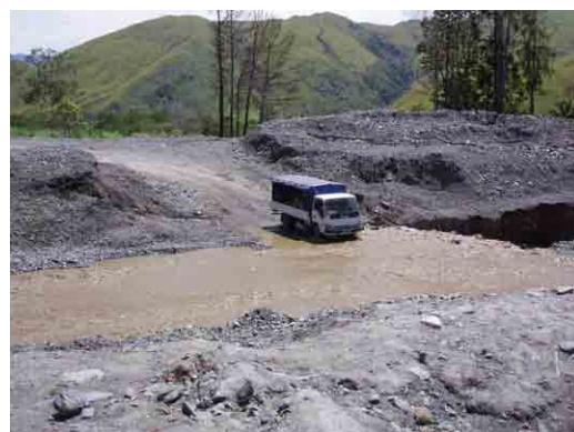
モロベ州の国道ワウ道路のプロロの洪水による道路流失
