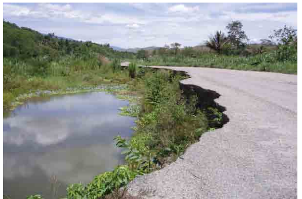
モロベ州ワウ道路の河川洗掘
