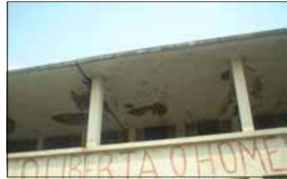
2: B 棟2 階の外部廊下天井 仕上げ材の剥落が多発している。
