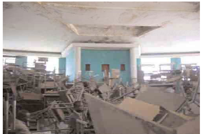
ルアンダ医療専門学校：使用されていない講堂内部、天井に雨漏り跡や亀裂が見られる
