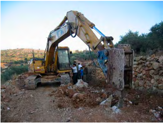
写真9 農業庁が2KRで調達したエクスカベーターを使用して農道の拡幅工事を実施しているところ。(カルキリア県ルバン村)
