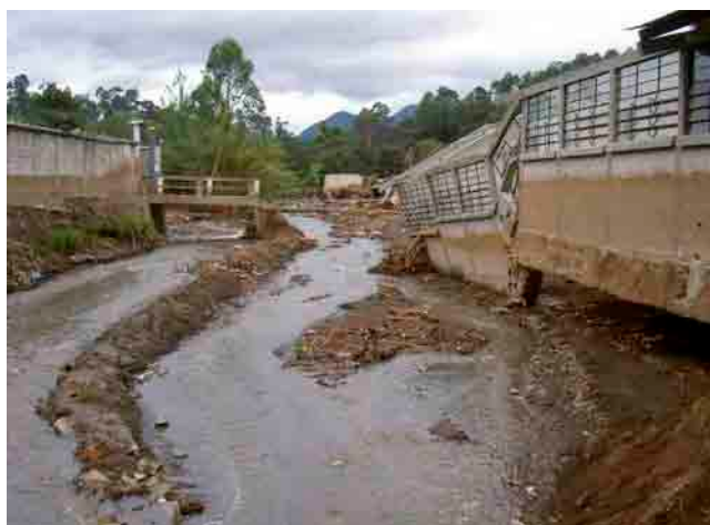
写真-9 ハリケーンスタン被災地、河川の氾濫により、破壊された小学校(生徒数:220名)の校舎及び橋梁(チマルテナンゴ県サンアンドレス市)
