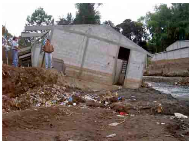
写真-10 同左、ハリケーンスタンによる河川の氾濫により破壊された小学校
