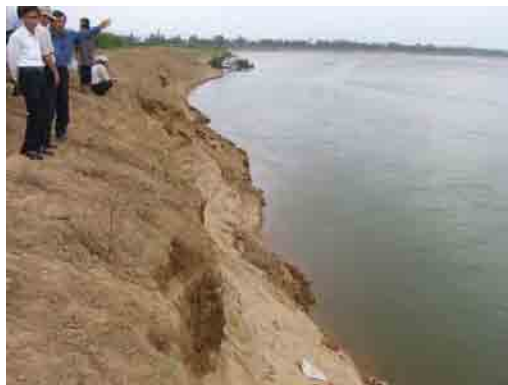
Thu Bon 川浸食箇所
