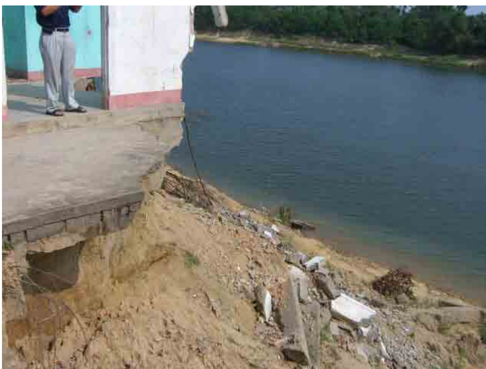
河岸浸食箇所 (Huong 川 Thua Thien Hue 省)。以前は、河川横に家屋が存在していたが、浸食により家屋が崩壊している。
