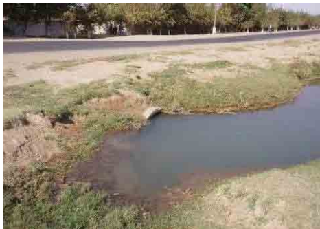
距離標 49+000 付近の横断管渠を通る道路および灌漑排水が滞水している。降水量の多い4月頃は路面冠水となる。
