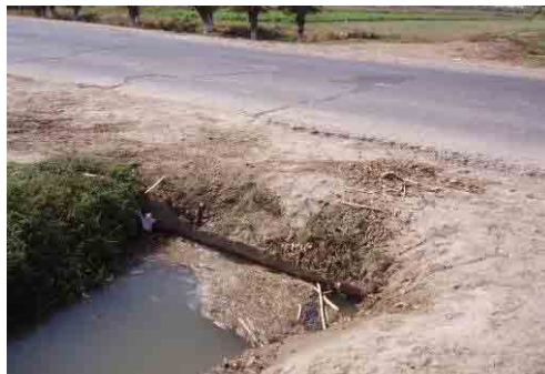
距離標 48+000 付近の横断管渠を通る道路及び灌漑排水が滞水している。降水量の多い4月頃は路面が冠水する。
