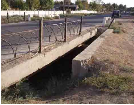
距離標 43+300、幅員：7.9m、橋長：10.0m (H鋼桁)、幅員が狭くRCの老朽化が顕著。
