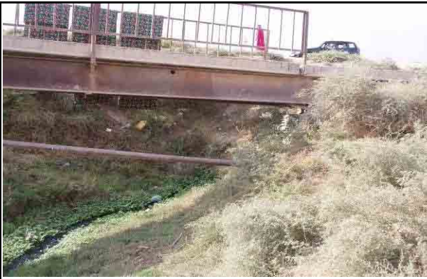
距離標 2+000、幅員：7.0m、橋長：13.0m、（鋼桁） 幅員が狭く耐荷力不足
