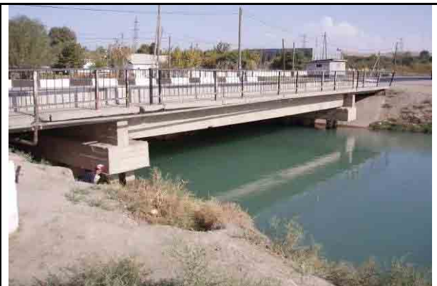
距離標 36+100、幅員：10.0m 橋長：31.5m (PC) 幅員が狭く PC 桁の耐荷力の調査を要する。
