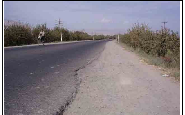
コルホゾバッドからクルガンチュベに向かう距離標 20+000 付近の舗装端の損傷と路肩との著しい段差
