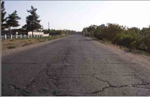
ドゥステイからコルホゾバッドに向かう距離標 40+000 付近、開口幅 10mm~25mm 程度のクラックが路面を覆う
