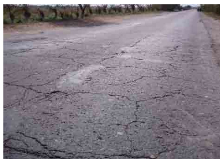
コルホゾバッドからクルガンチュベ方向の距離標 10+000 付近、開口幅 10mm～20mm 程度の深い網状クラックが路面を覆う
