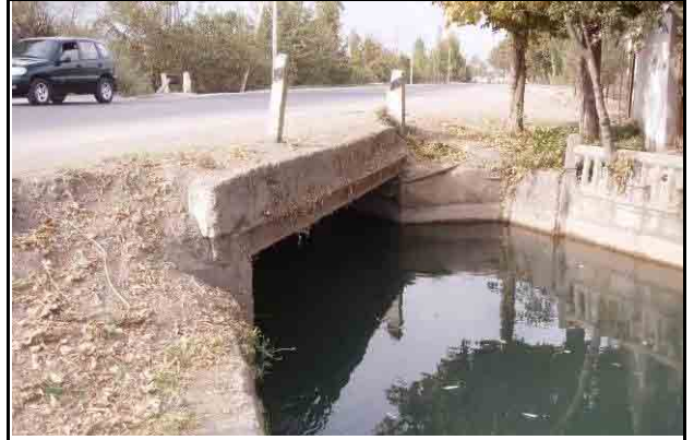
距離標 1+900、幅員：7.0m、橋長：4.0m、（鋼桁） 幅員が狭く RC の劣化
