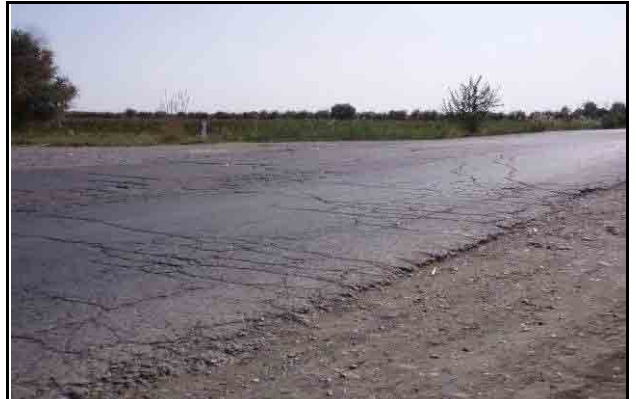
距離標 46+000 付近、開口幅 10mm~25mm、路盤まで達していると思われる網状クラックが路面を覆う
