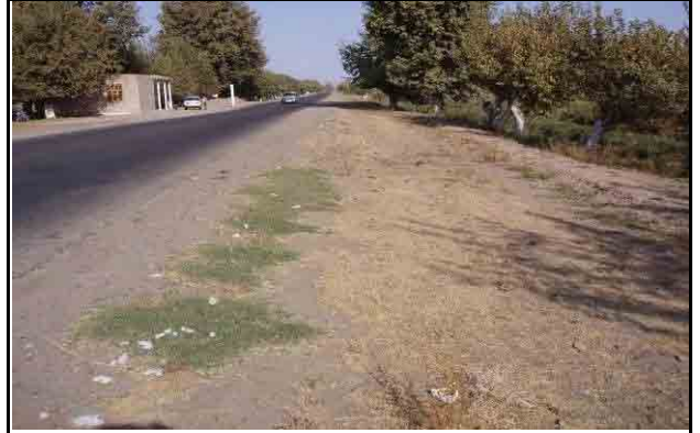
ドゥスティからコルホゾバッドに向かう距離標 57+000 付近、20~40m の波長で道路延長方向に大きく波打つ凹凸が続く
