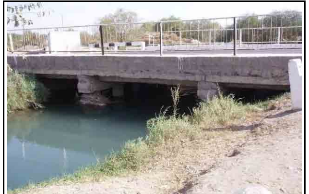
距離標 14+700、幅員：11.1m、橋長：12.1m（RC 桁） 下部工 RC のひび割れや劣化
