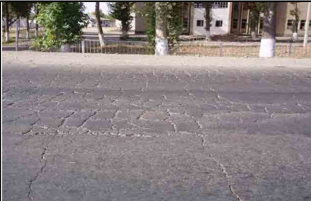
距離標 49+000 付近、開口幅 10mm~25mm、路盤まで達していると思われる網状クラックが路面を覆う
