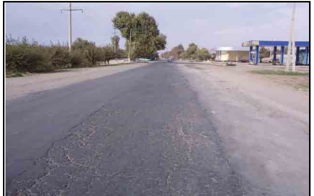
コルホゾバッドからクルガンチュベ方向の距離標 2+000 付近、アスファルト舗装の幅員が 5m 程度しかない箇所が 1km 程続く
