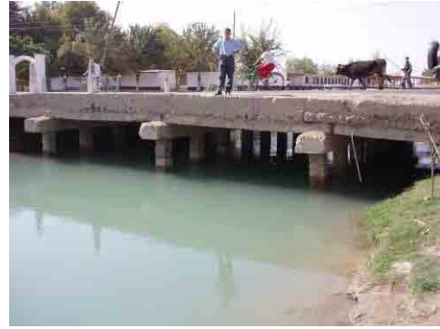
距離標 51+300、幅員：11.0m、橋長：18.5m (RC桁)、幅員が狭く下部工のRCの品質不良
