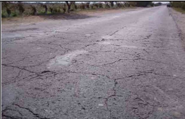
コルホゾバッドからクルガンチュベ方向の距離標 10+000 付近、開口幅 10mm~20mm 程度の深い網状クラックが路面を覆う
