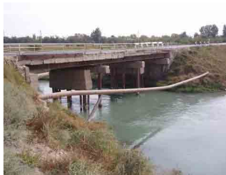
距離標 30+700、幅員：7.1m、橋長：28.4m （H 鋼）幅員が狭く橋脚、橋台の変形や RC の劣化が著しい。
