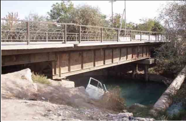
距離標 1+500、幅員：7.0m、歩道：2@1.0m、橋長：22.2m （鋼桁）、幅員が狭く鋼桁の腐食が著しい
