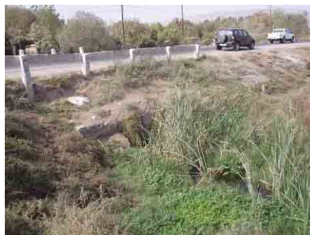
距離標 30+000 付近の横断管渠の土砂で埋まっている呑口
