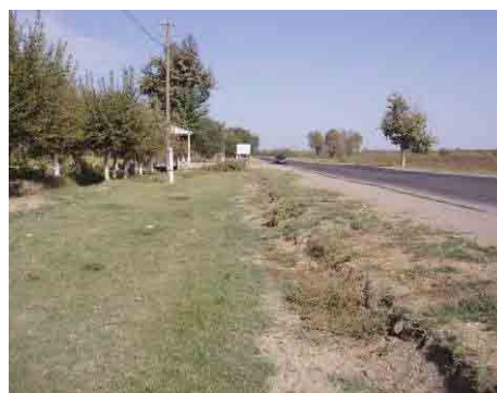
ドゥスティからコルホゾバッドに向かう距離標 45+000 付近、20～50m の波長で道路延長方向に大きく波打つ路面の凹凸が続く
