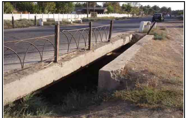
距離標 43+300、幅員：7.9m、橋長：10.0m (H鋼桁) 幅員が狭く RC の老朽化が顕著。
