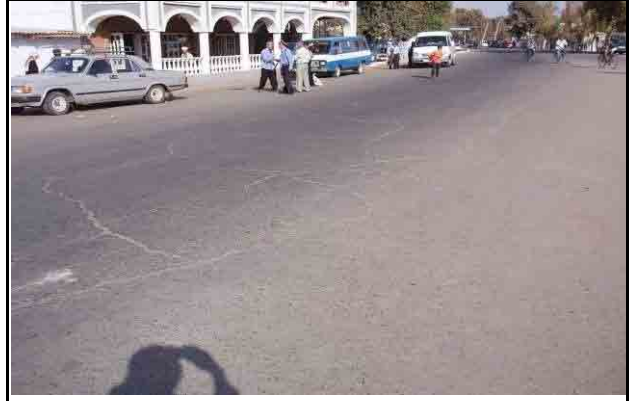
コルホゾバッド市内の路面状況、浅い網状クラックやラベリングも見られるが総じてよい状態に維持されている。
