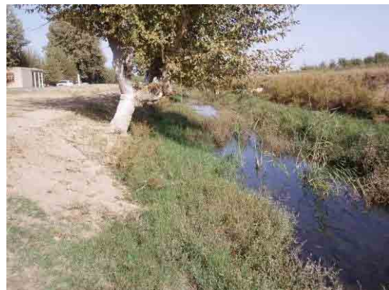
距離標 55+000 付近の道路側溝（素掘り）、側溝内には雑草が繁茂しており、道路および灌漑排水が滞水している。
