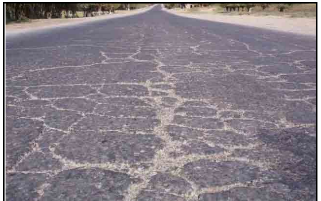
ドゥスティからコルホゾバッドに向かう距離標 42+000 付近、開口幅 10mm~30mm 程度の深い網状クラックが路面を覆う
