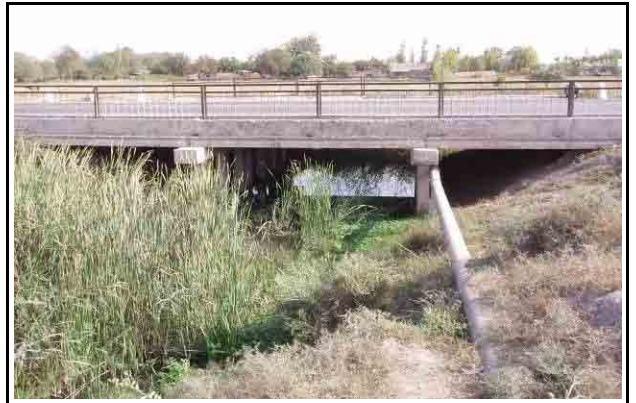
距離標 11+300、幅員：12.4m、橋長：18.4m、（RC 桁） 下部工 RC の品質不良
