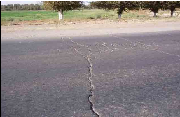
距離標 50+000 付近、路面には、開口幅 25mm 程度、路床まで達していると思われる深い線状クラックがある
