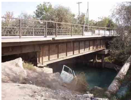
距離標 1+500、幅員：7.0m、歩道：2@1.0m 橋長：22.2m（鋼桁）、幅員が狭く鋼桁の腐食が著しい
