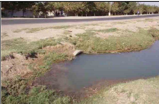
距離標 49+000 付近の道路と灌漑排水の道路横断管渠、流下能力が落ち、農繁期や降雨量の多い3~5月頃は路面が冠水する。
