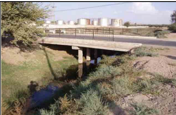
距離標 46+800、幅員 9.0m、橋長：15.0m (RC) 幅員が狭く下部工 RC の品質不良
