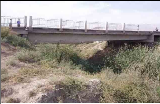
距離標 30+500、幅員：8.5m、歩道 2@1.0、橋長：17.0m (RC)、幅員が狭く RC 桁の耐荷力の調査を要する。
