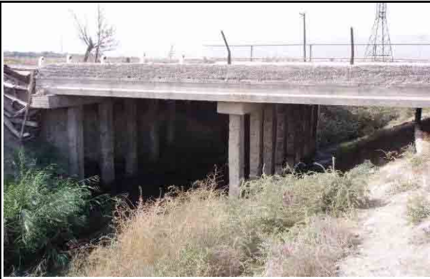
距離標 13+500、幅員：11.8m、橋長：11.2m、（RC 桁） 下部工 RC の品質不良
