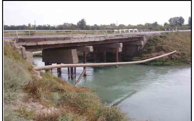
距離標 30+700、幅員：7.1m、橋長：28.4m (H鋼) 幅員が狭く橋脚、橋台の変形や RC の劣化が顕著。
