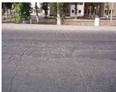
距離標 49+000 付近、開口幅 10mm～25mm、路盤まで達していると思われる網状クラックが路面を覆う
