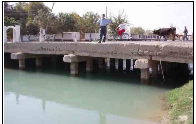
距離標 51+300、幅員：11.0m、橋長：18.5m (RC) 幅員が狭く下部工 RC の品質不良
