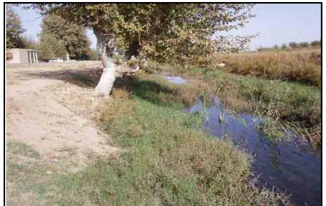
距離標 55+000 付近の道路側溝(素掘)、側溝内には雑草が繁茂しており、道路および灌漑排水が滞水している。
