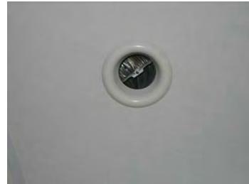
天井吹き出し口
