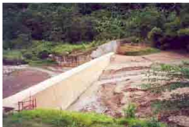
マナンガ I プロジェクト：頭首工堆砂状況
