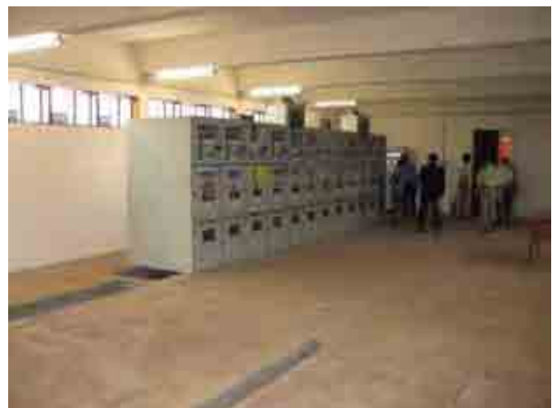
ブラックホールロード変電所 配電盤室の様子
