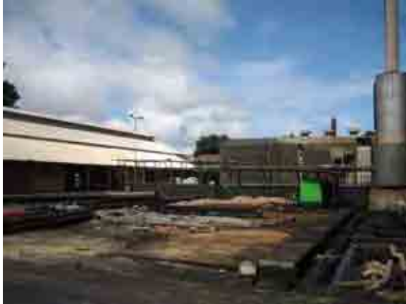
ディーゼル発電機据付予定地
