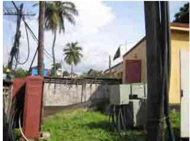
コンゴクロス変電所の様子
