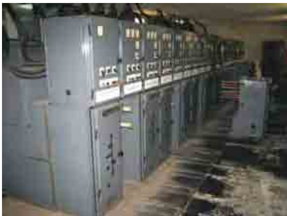
既設 11kV 配電盤
