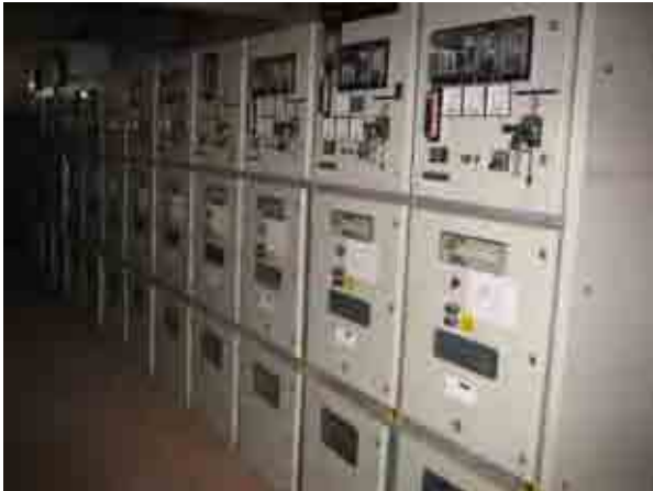
既設変電所の様子 既設 11 kV 配電盤の様子
