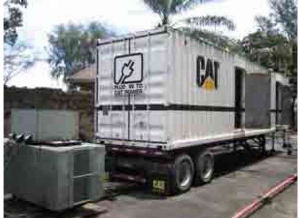
既設ディーゼル発電設備(ピーク負荷用)
