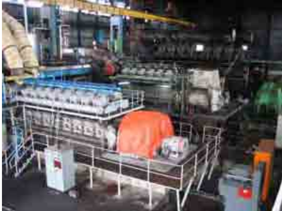
既設ディーゼル発電機(ベース負荷用)
