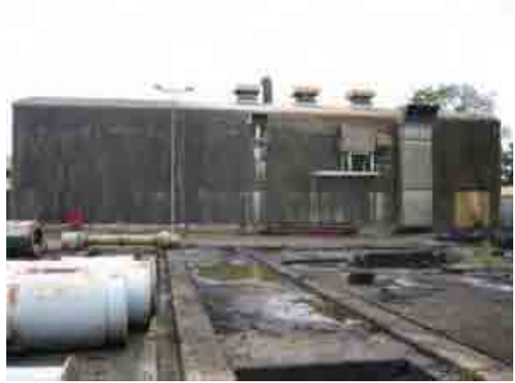
前回協力で供与したディーゼル発電設備
