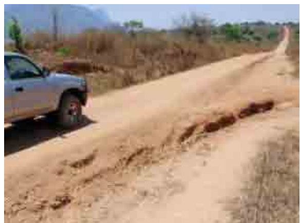
クアンバ〜ナンブラ間の幹線道路の状況。雨期になると路盤が流され、深い轍(わだち)ができ大型車の通行に支障を来す。
